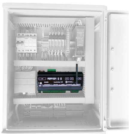
quadro elettrico di monitoraggio
